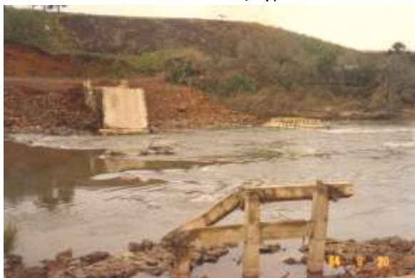
Ponte sobre o Rio Marombas destruído
